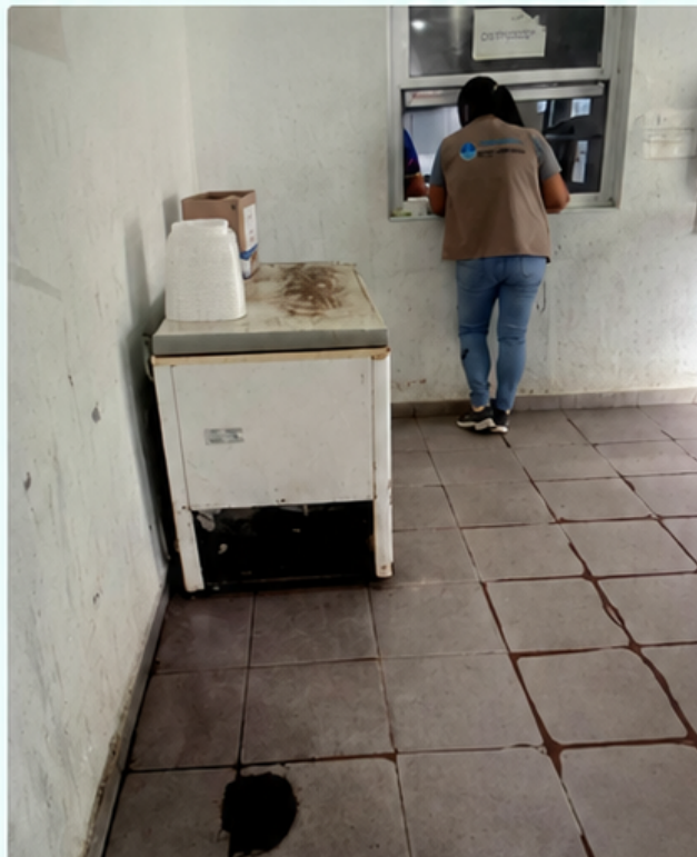
Espacio Alternativo de Contención N° 3: Cloacas abiertas con pozos grandes en el comedor.
