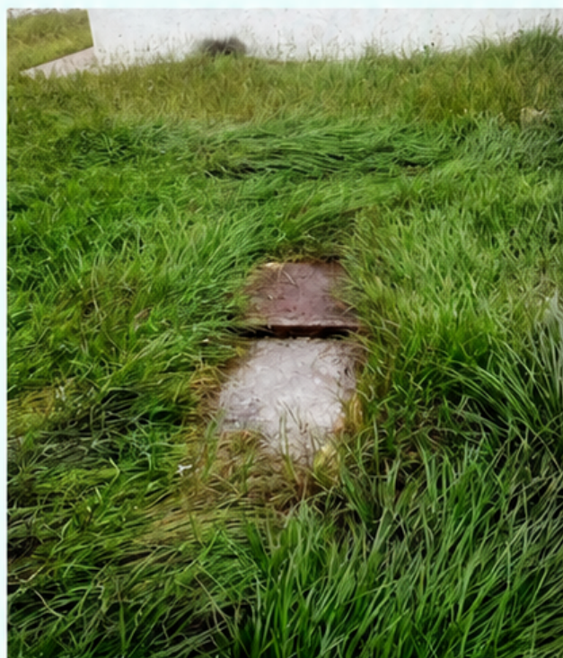
Espacio Alternativo de Contención N° 3: Cloacas que rebalsan en patio.
