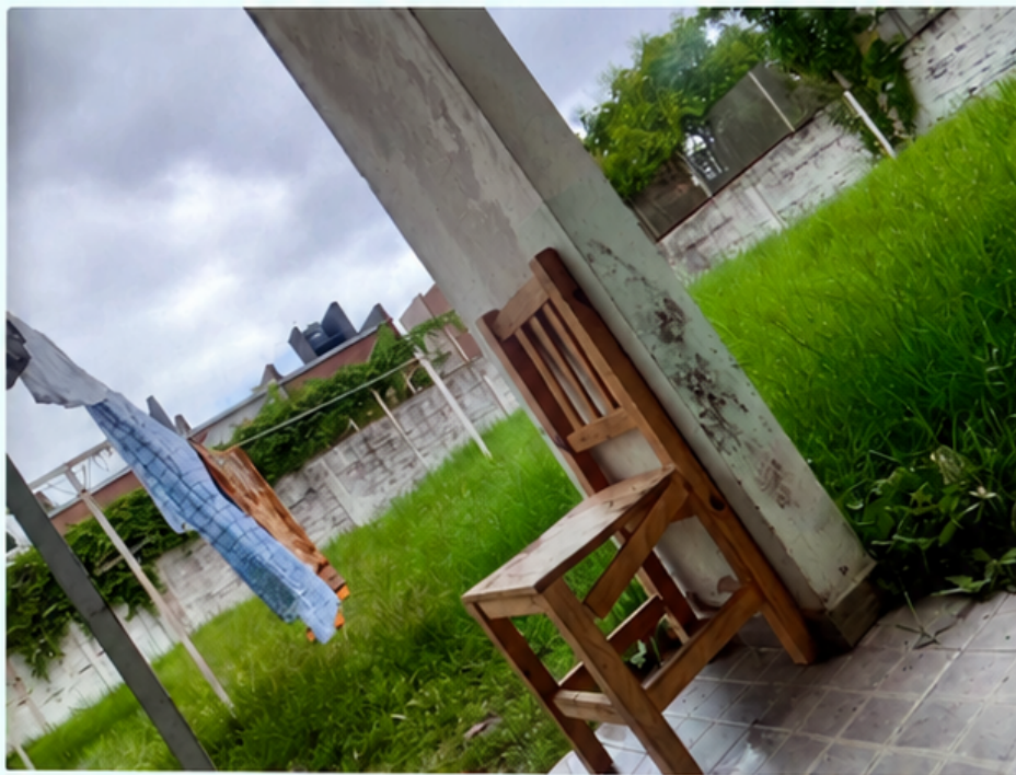
Espacio Alternativo de Contención N° 3: patio en total abandono.
