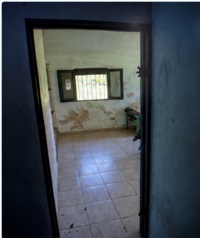
CSE Aldea Tres Horquetas: falta de puertas en las habitaciones
